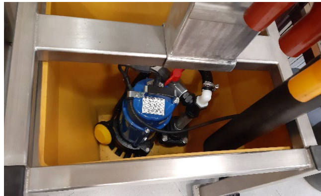
Fig. 4 Caja recolectora con bomba de agua
