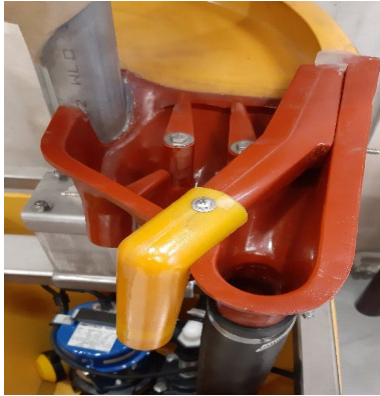
Fig. 3 Separadores deslizantes o splitters
